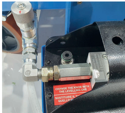
Abbildung 6.3.4 Aufkleber auf Luft-Hydraulik-Pumpe: „Ersetzen Sie den Blindstutzen durch den mitgelieferten Kupplungsstecker.“
