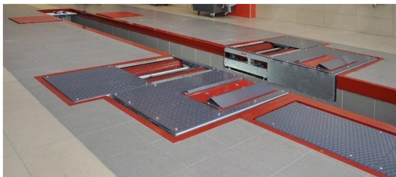
Einbau unterflur (als Teil einer Prüfstraße), mit Arbeitsgrube Bauweise Kompakt geteilt
